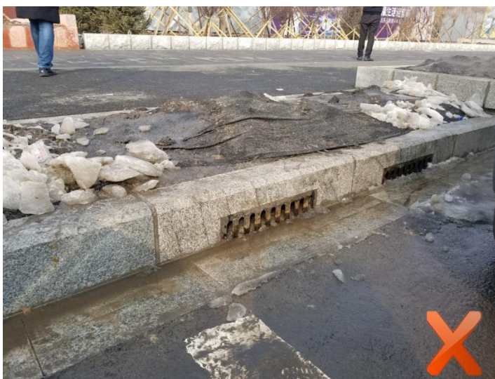
错误做法1: 下沉绿化带未按照设计实施，造成雨水排放通道被堵塞
